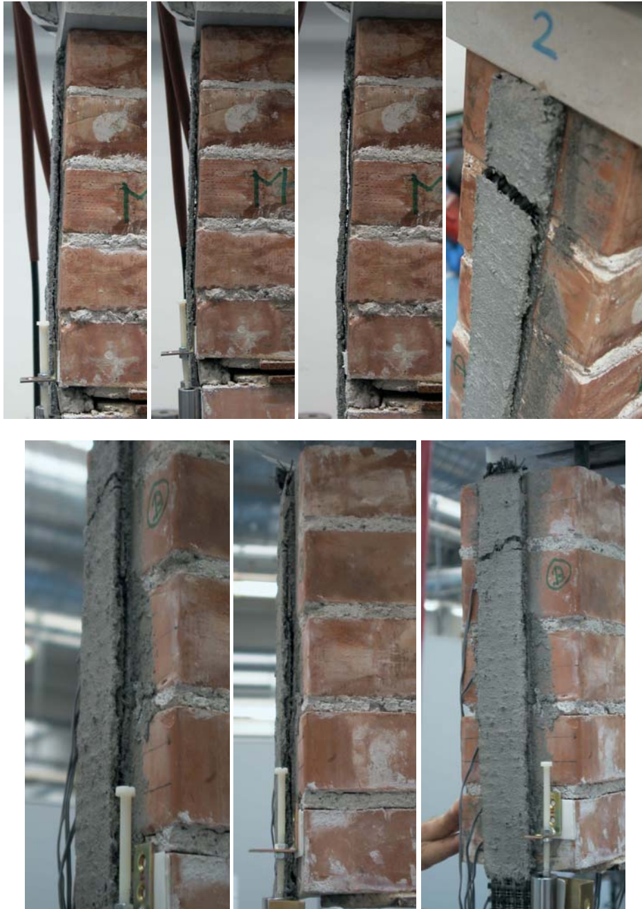
Figura 4.15 delaminazione mista C) D) E) tra CFRCM e muratura
