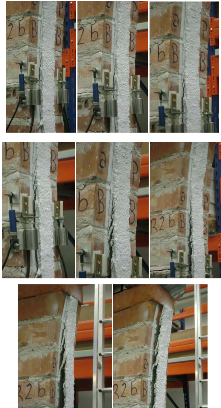
Figura 4.17 delaminazione mista B) C) D) tra CFRCM e muratura curva
