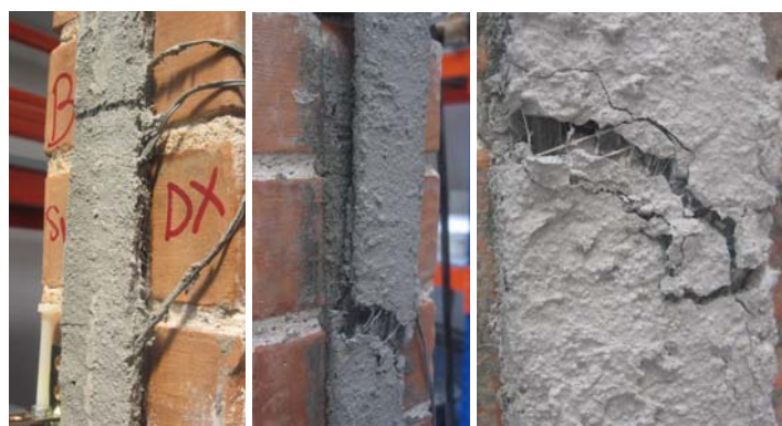
Figura 4.13 dettaglio della delaminazione E) per ancoraggi 315 mm tra CFRCM e muratura
