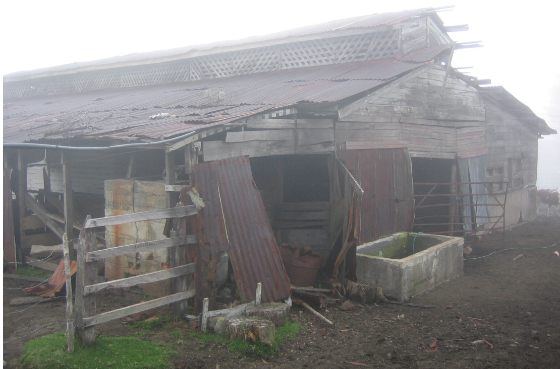
Fig.5.28. Fattoria abbandonata alla base del vulcano Turrialba. I gas acidi della plume hanno corrosato il tetto e le pareti in lamiera.
