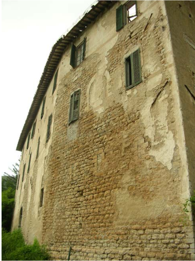
4.3. Leggiana, Il Palazzo, deviazione della facciata
