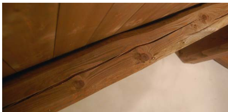
Fig. 1.19 – trave di legno fessurata posta in opera
