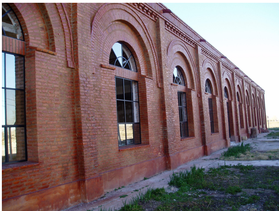
Figura 9.17 L'edificio della Escuela agrícola J. J. Gómez dopo l'opera di restauro (Archivio fotografico di Carlos Magdalena, INTA)
