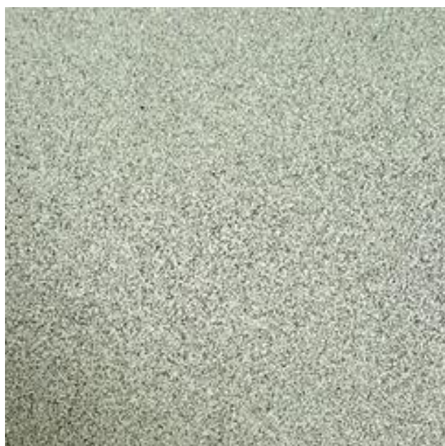
Figura 9.4 - Guaina bituminosa con ghiaia, mostra un comportamento misto diffusivo-RR.
