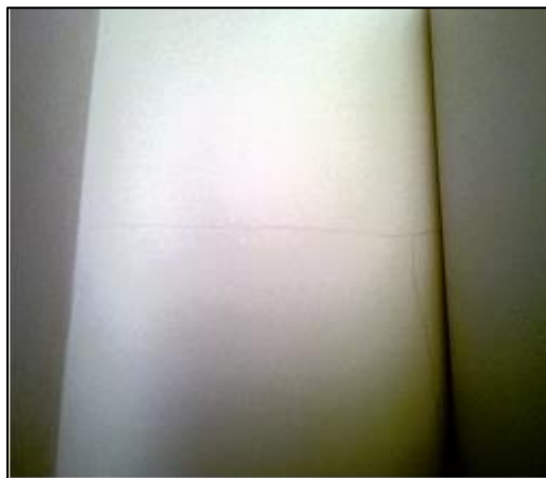
Fig. 8: esempio di danno di soglia
