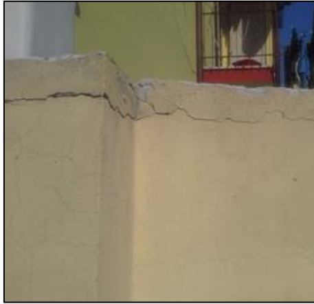
Fig. 9: esempio di danno di minore
