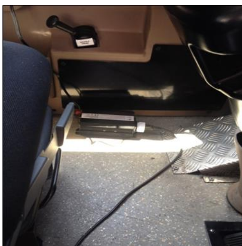
Fig. 126: batteria di supporto
