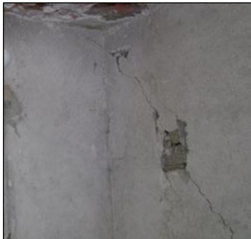
Fig. 10 : esempio di danno di maggiore
